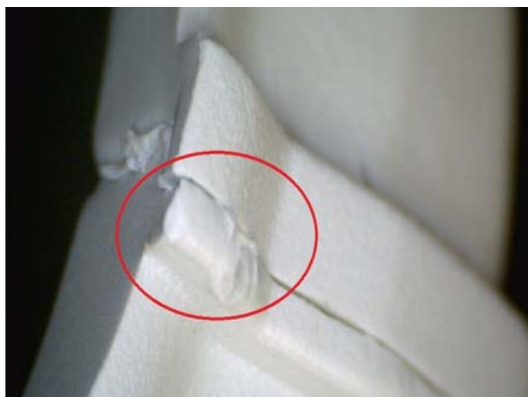
Obr.11 Poškodenie zváraných častí v mieste zvaru
