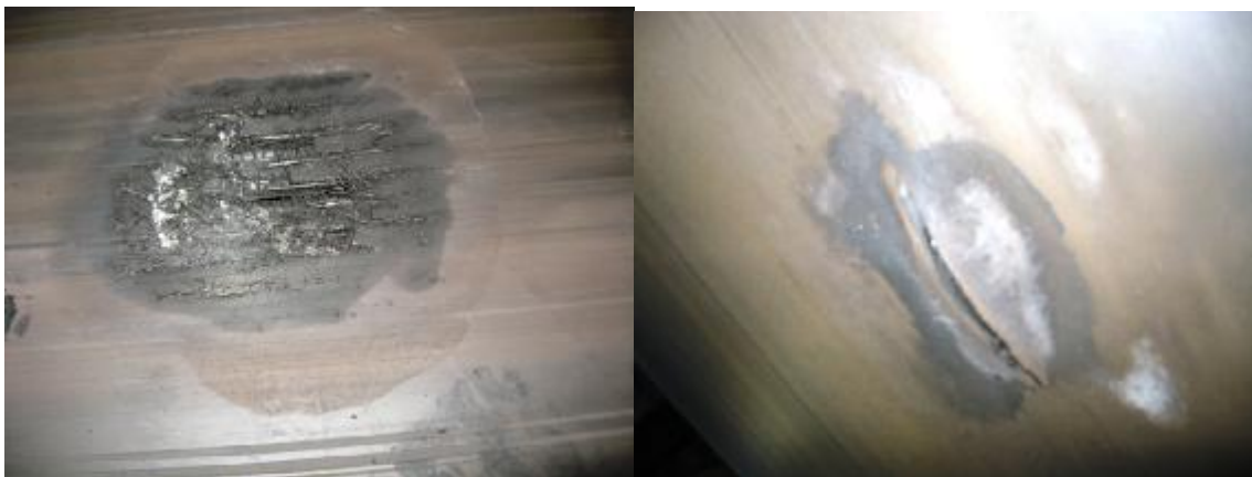
Rys. 7 Powierzchnia taśmy z uszkodzeniem skupionym linek stalowych - widok na górną i spodnią część taśmy
